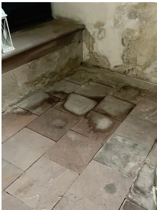
Fot. nr 12. Widok przed renowacją – zawilgocenia.
