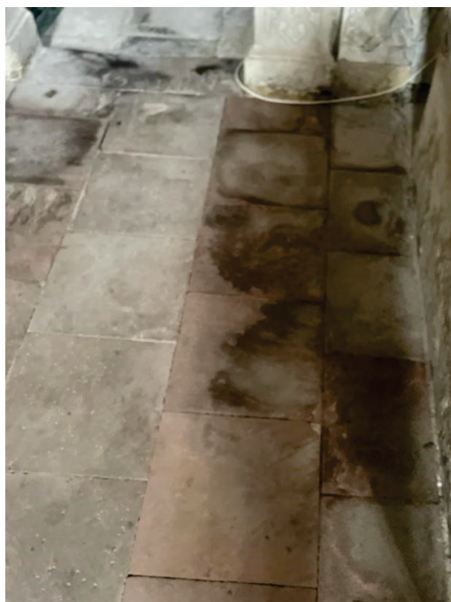
Fot. nr 4. Widok przed renowacją – zawilgocenia.
