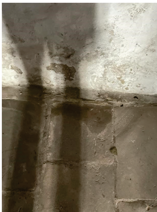
Fot. nr 15. Widok przed renowacją – zawilgocenia.
