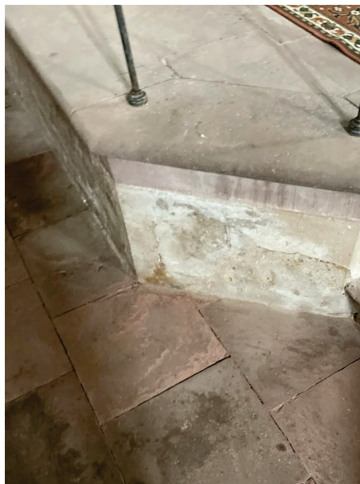
Fot. nr 3. Widok przed renowacją – zatarte lico piaskowca oraz zawilgocenia.
