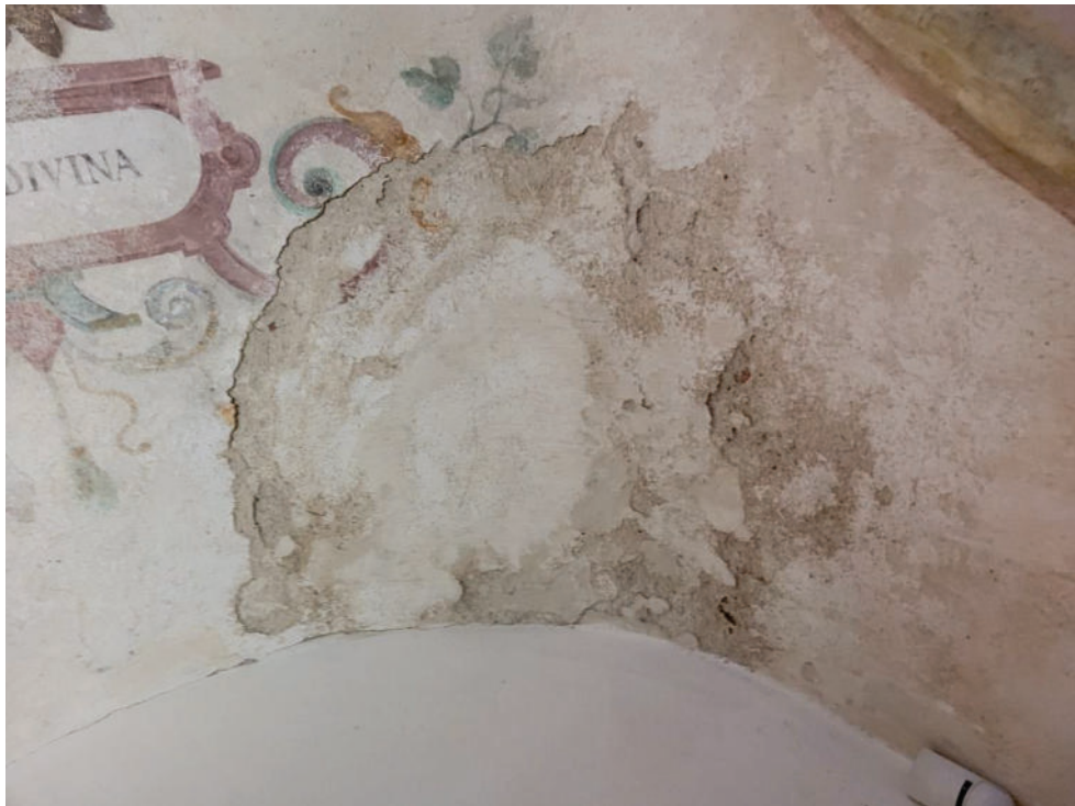
Fot. 12. Kościół pw. Świętej Trójcy w Żórawinie, wnętrze kościoła, Widok na sklepienie nawy. Wysklepka sklepienna w narożniku pd-zach. Widoczne zniszczenia na skutek zalania. Zauważalna degradacja i zasolenie warstw zaprawy. Stan przed konserwacją, fot. I. Widlińska 2022
