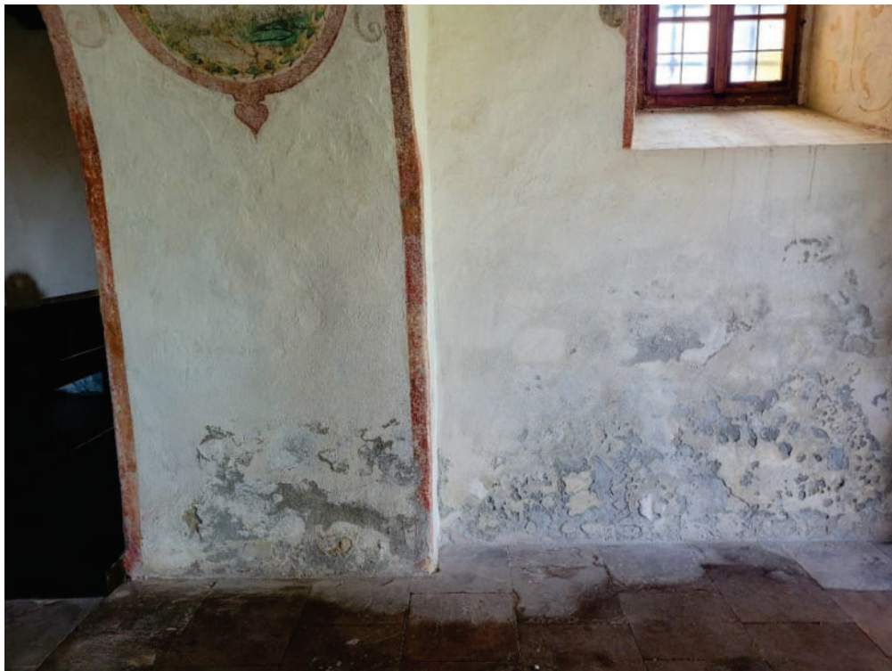
Fot. 17. Kościół pw. Świętej Trójcy w Żórawinie, wnętrze kruchty wejściowej kościoła, fragment ściany południowej. Zauważalna degradacja i zasolenie warstw zaprawy w partii cokołowej ściany. Widoczne cementowe uzupełnienia. Stan przed konserwacją, fot. I. Widlińska 2022
