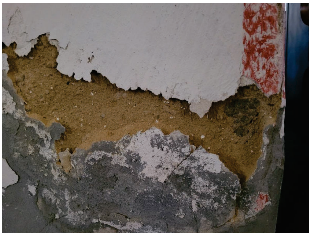
Fot. 19. Kościół pw. Świętej Trójcy w Żórawinie, wewnątrz nawy kościoła, fragment ściany południowej. Zauważalna degradacja i zasolenie warstw zaprawy w partii cokołowej ściany. Stan przed konserwacją, fot. I. Widlińska 2022
