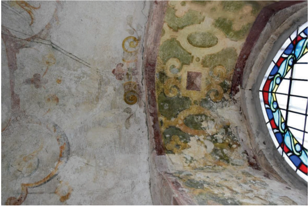
Fot. 14. Kościół pw. Świętej Trójcy w Żórawinie, wnętrze kościoła, Widok na glif okna w nawie na wysokości łoży kolatorskiej oraz na fragment sklepienia, Strona północna nawy, Zniszczenia wynikające z zalania. Stan przed konserwacją, fot. I. Widlińska 2022
