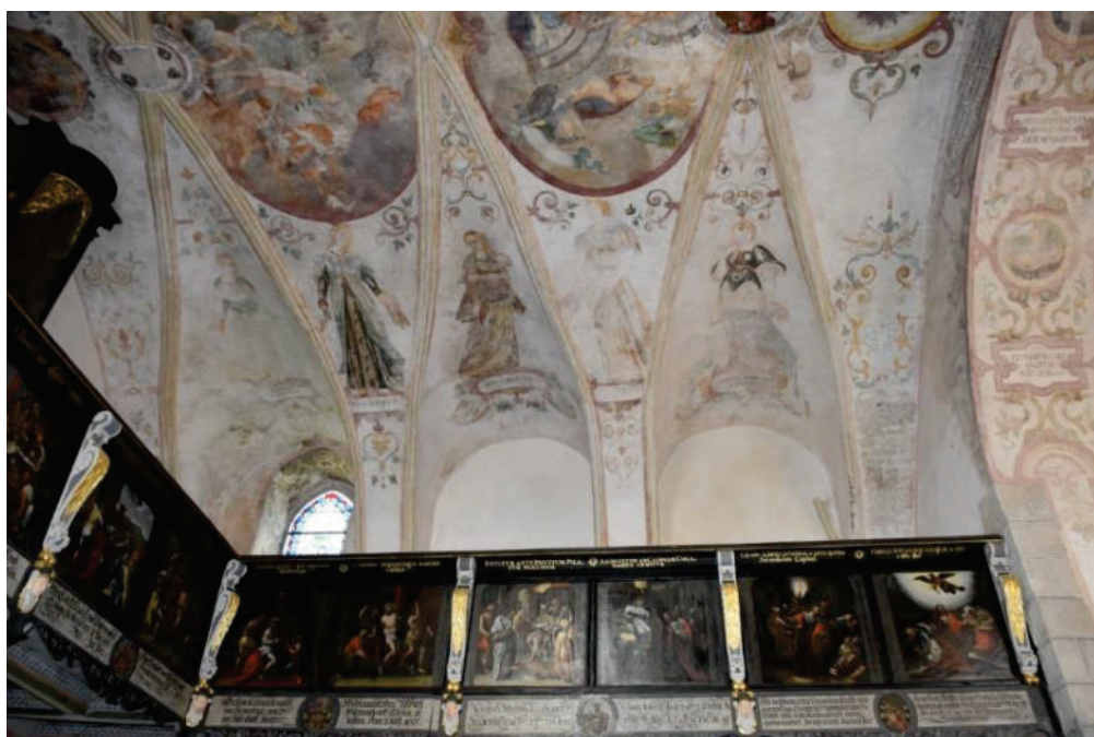
Fot. 6. Kościół pw. Świętej Trójcy w Żórawinie, wewnątrz kościoła, Widok na sklepienie nawy, Strona północna. Widoczne degradacja zapraw i warstwy malarskiej w partii splywu i glifu okiennego. Stan przed konserwacją, fot. I. Widlińska 2022
