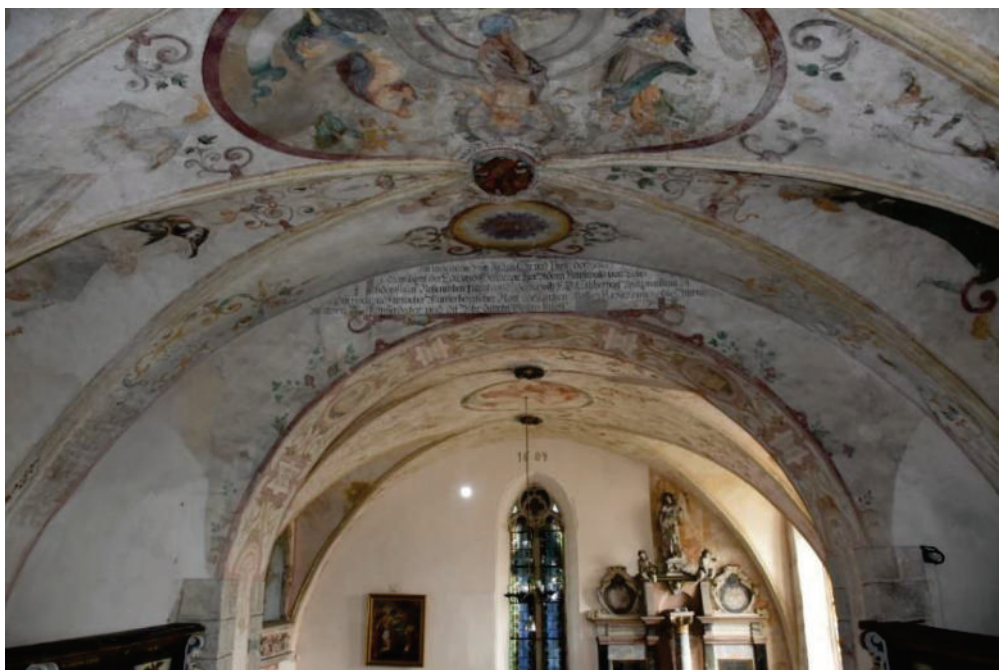
Fot. 4. Kościół pw. Świętej Trójcy w Żórawinie, wnętrze kościoła, Widok na sklepienie nawy od empory. Widoczne zabrudzenie i zaplamienia dekoracji malarskiej. Stan przed konserwacją, fot. I. Widlińska 2022
