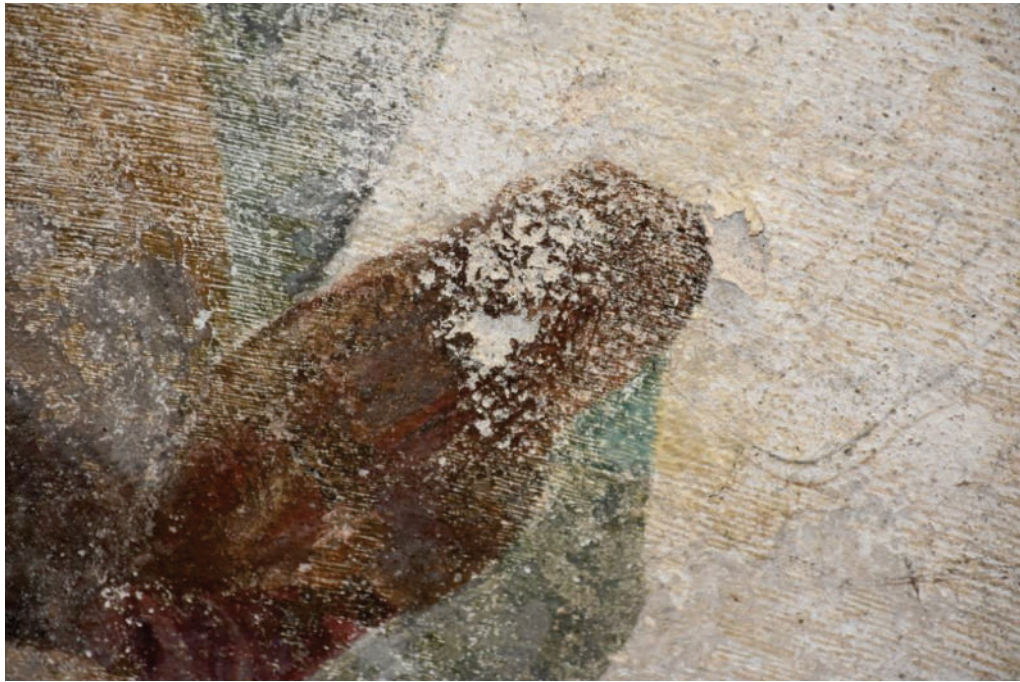
Fot. 15. Kościół pw. Świętej Trójcy w Żórawinie, wnętrze kościoła, fragment polichromii na sklepieniu nawy, Strona południowa nawy, Stan przed konserwacją, Widoczne uzupełnienia polichromii PP PKZ znakiem graficznym kreską, a także odspojone fragmenty dekoracji. fot. I. Widlińska 2022
