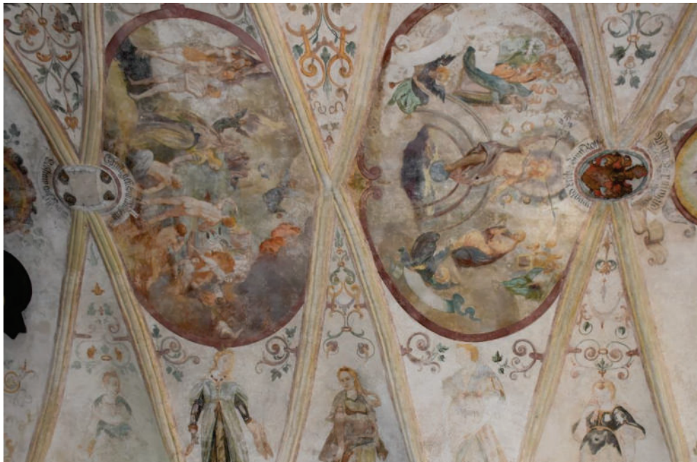
Fot. 27. Kościół pw. Świętej Trójcy w Żórawinie, wnętrze kościoła, Widok na sklepienie nawy. Widoczny brak jednego zwornika sklepiennego. Stan przed konserwacją, fot. I. Widlińska 2022
