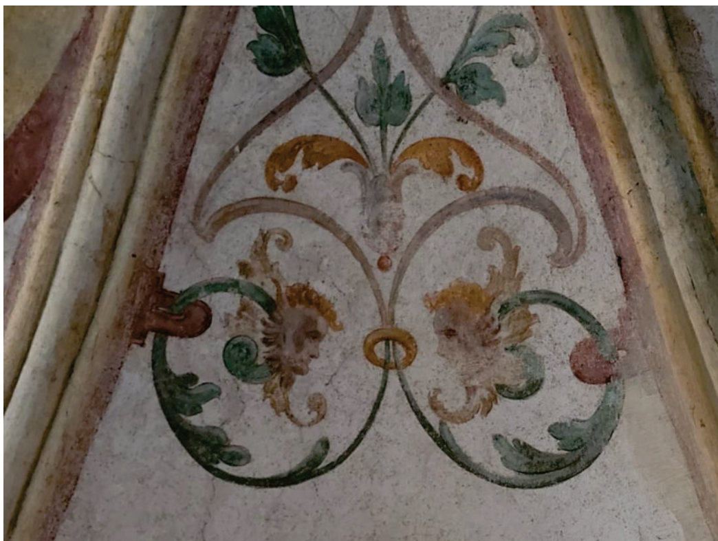
Fot. 24. Kościół pw. Świętej Trójcy w Żórawinie, wewnątrz kościoła, Widok na sklepienie nawy. Wysklepka sklepienna w narożniku pd-zach. Widoczne pajęczynowe spękania. Stan przed konserwacją, fot. I. Widlińska 2022
