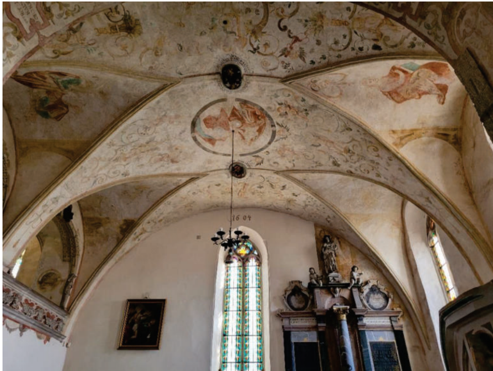
Fot. 3. Kościół pw. Świętej Trójcy w Żórawinie, wnętrze kościoła, Widok na sklepienie prezbiterium od strony zachodniej, Stan przed konserwacją, Widoczny silny kontrast między monochromia ścian a tłem dekoracji malarskiej. fot. I. Widlińska 2022
