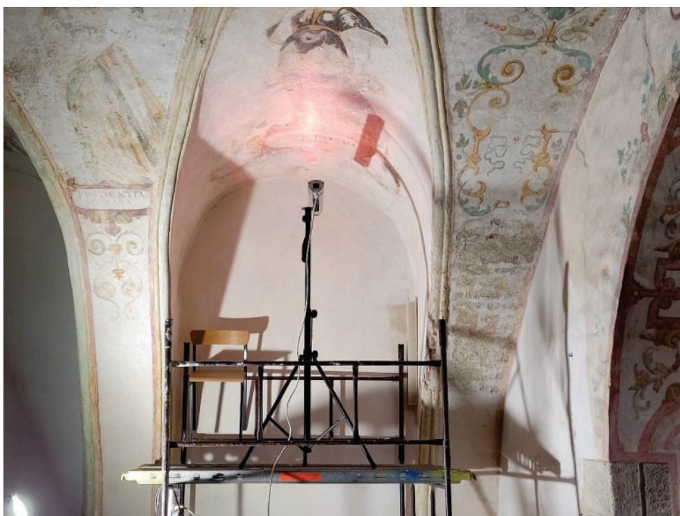
Fot. 4. Kościół pw. Świętej Trójcy w Żórawinie, wewnątrz kościoła, nawa. Widok na ścianę północną na wysokości empory. Stan w trakcie ogrzewania fragmentu malowidła promiennikiem podczerwieni. Fot. I. Widlińska 2022
