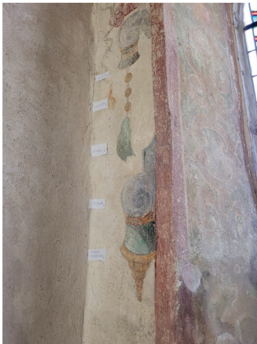
Fot. 22. Kościół pw. Świętej Trójcy w Żórawinie, wnętrze kościoła, nawa. Fragment ściany południowej blisko okna. Widoczne próby czyszczenia malowidła. Stan w trakcie badań. Fot. I. Widlińska 2022
