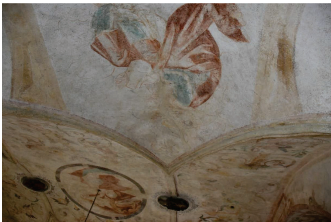
Fot. 10. Kościół pw. Świętej Trójcy w Żórawinie, wewnątrz kościoła, Widok na sklepienie prezbiterium. Fragment postaci ewangelisty. Widoczne bardzo słabo lub nie zachowane partie dekoracji malarskiej. Stan przed konserwacją, fot. I. Widlińska 2022
