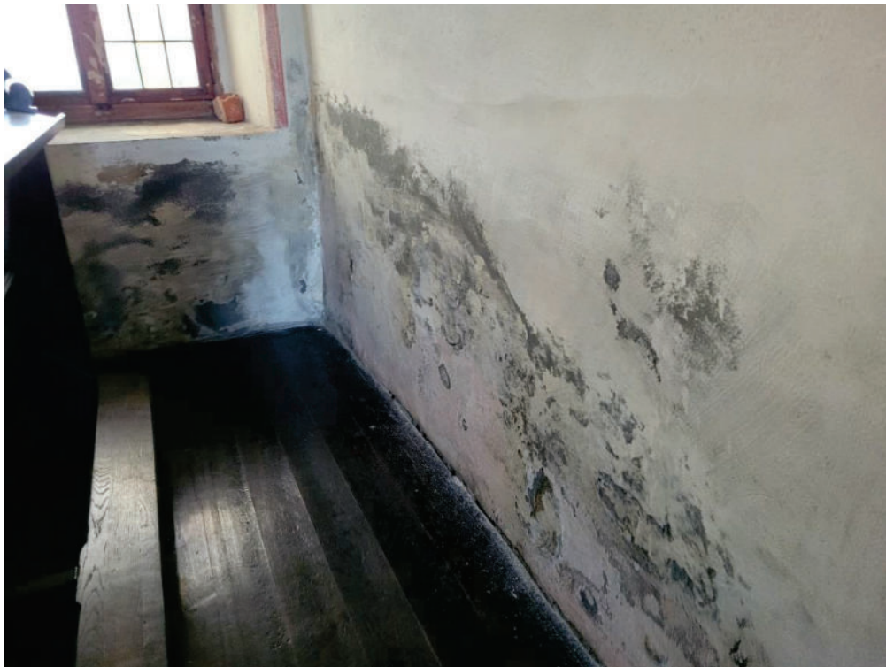
Fot. 16. Kościół pw. Świętej Trójcy w Żórawinie, wnętrze nawy kościoła, Widok na narożnik pd-zach nawy. Zauważalna degradacja i zasolenie warstw zaprawy w partii cokołowej ścian. Widoczne cementowe uzupełnienia. Stan przed konserwacją, fot. I. Widlińska 2022
