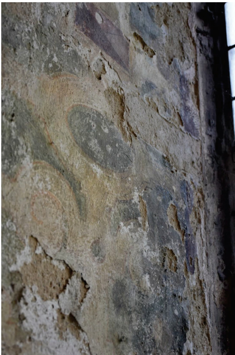
Fot. 13. Kościół pw. Świętej Trójcy w Żórawinie, wnętrze kościoła, Widok na glif okna w nawie na wysokości łoży kolatorskiej, Strona północna nawy, zauważalna silna degradacja warstw stratygraficznych polichromii. Stan przed konserwacją, fot. I. Widlińska 2022
