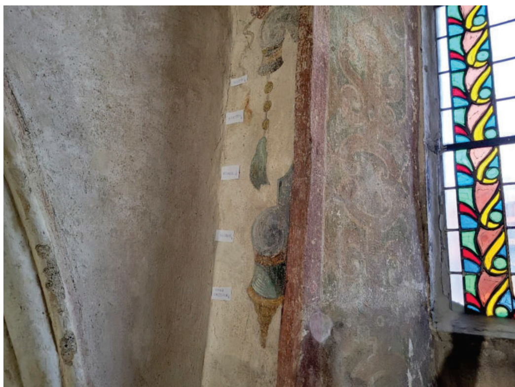
Fot. 25. Kościół pw. Świętej Trójcy w Żórawinie, wewnątrz kościoła, Widok na ścianę południową nawy. Fragment ściany z wykonaniem prób oczyszczania. Stan przed konserwacją, fot. I. Widlińska 2022
