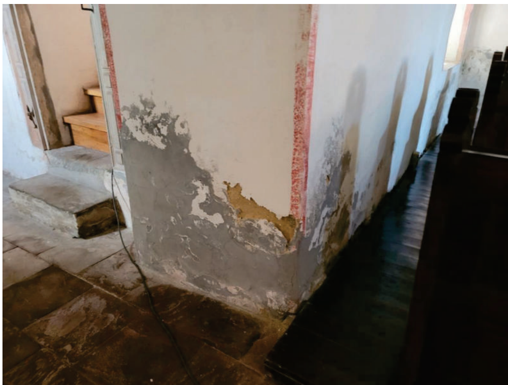
Fot. 18. Kościół pw. Świętej Trójcy w Żórawinie, wewnątrz nawy kościoła, fragment ściany południowej. Zauważalna degradacja i zasolenie warstw zaprawy w partii cokołowej ściany. Widoczne cementowe uzupełnienia. Stan przed konserwacją, fot. I. Widlińska 2022
