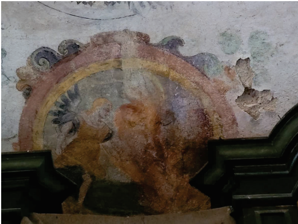
Fot. 11. Kościół pw. Świętej Trójcy w Żórawinie, wnętrze kościoła, Widok na sklepienie nawy. Scena figuralna nad prospektem organowym. Widoczne zabrudzenie i zaplamienia dekoracji malarskiej wynikające z użycia bieli ołowiowej. A także zniszczenia na skutek zalania. Stan przed konserwacją, fot. I. Widlińska 2022
